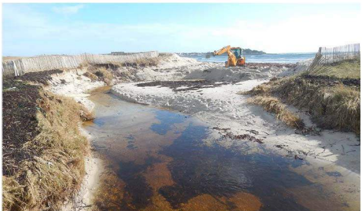
Brèche au niveau de l'exutoire de la Dour Red – commune de Guilvinec (photo Egis 25 février 2014)
